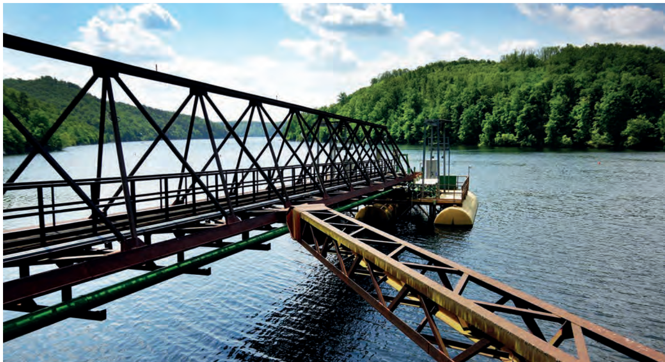
Čerpací stanice ve Štítarech
