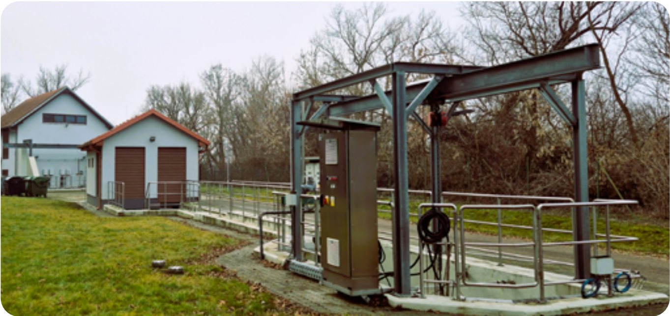
Čerpací stanice odpadních vod Ponětovice
