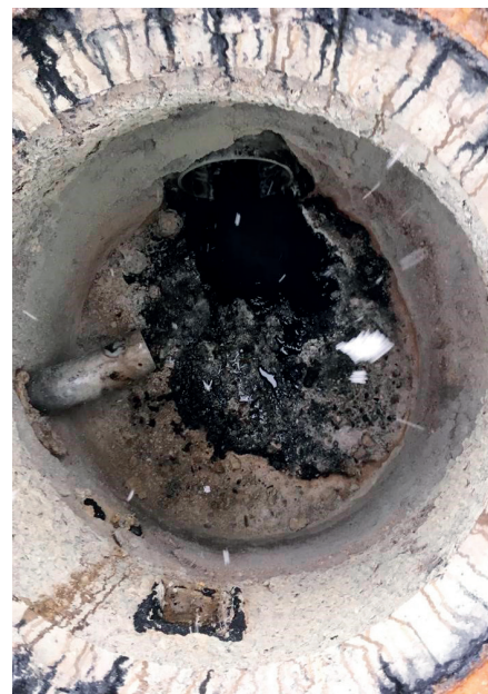
Silně degradovaná šachta, do které je zavedena přípojka od průmyslového znečišťovatele.
