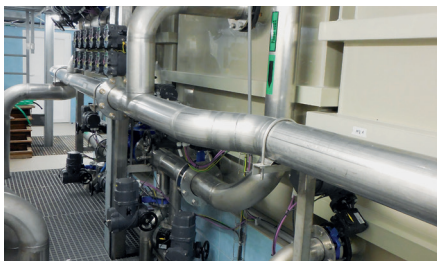
Úpravna vody dostala také nové potrubní vystrojení
