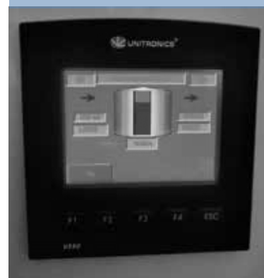
Touch panel PLC Unitronics 350, který telemetricky řídí vodojem v Horních Dunajovicích
