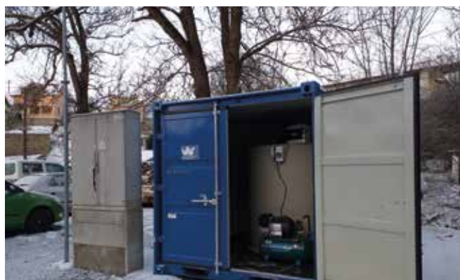
Mobilní protizápachové zařízení bylo jako první instalováno v Plenkovicích
