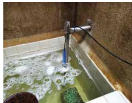
Měřicí zařízení bylo nainstalováno v pramenní jímkce
