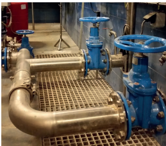
Vnitřní vstrojení vodojemu Prace
