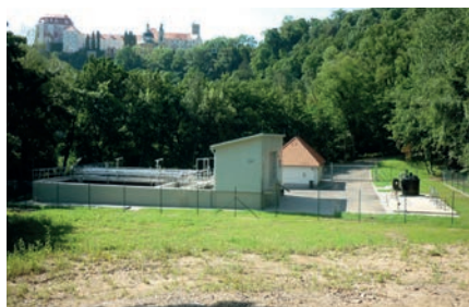
Čistírna odpadních vod má nyní kapacitu 1 800 EO
