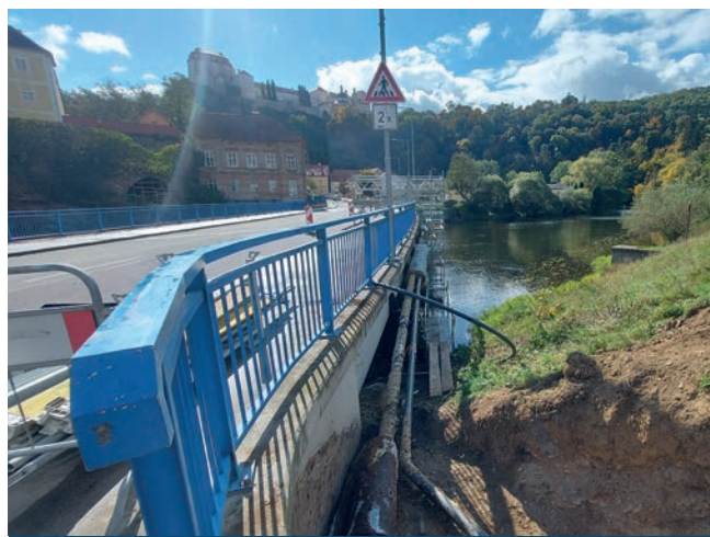
Poruchy se na vodovodním a kanalizačním potrubí stále opakovaly, výměna tedy byla nevyhnutelná
