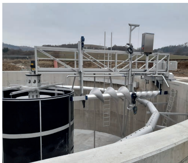
Šnekové stírání hlaliny u nové dosazovací nádrže
