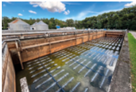
Zkouška funkčnosti nového aeračního systému
