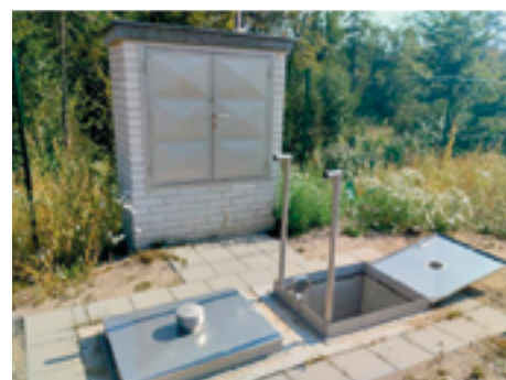
Akumulace + čerpací stanice Stříbrná studánka
