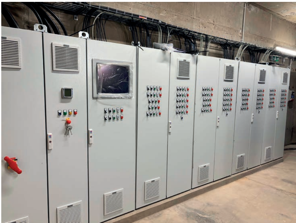
Nové elektrorozvaděče ve dmychárně
